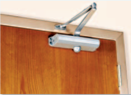
Gambar Foto 2.2.3 Pautan atau 'linkage' digunakan pada pintu
