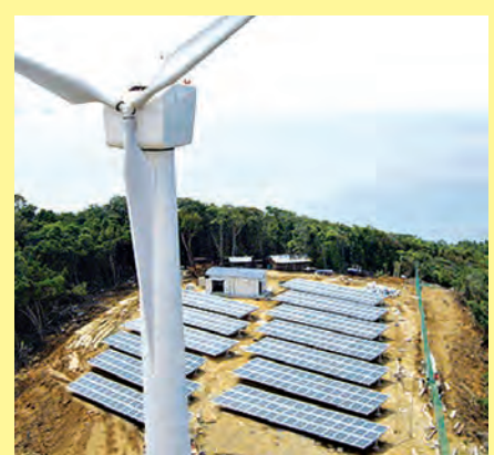
Stesen jana kuasa hibrid di Pulau Perhentian Kecil, Terengganu (Sumber tenaga: Angin, Solar, Diesel)
