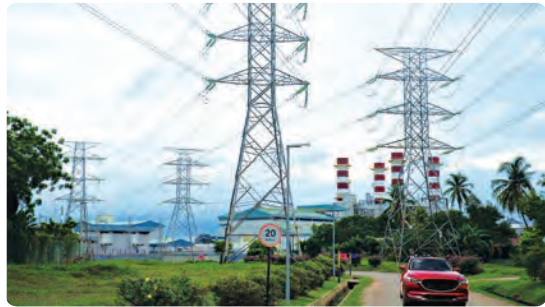
Kabel penghantaran arus ulang-alik pada 132 kV di stesen jana kuasa Tanjung Kling, Melaka.
