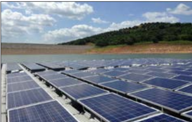
Stesen Janakuasa Solar di Sepang, Selangor
