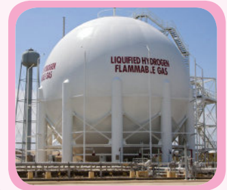
Tangki simpanan hidrogen
