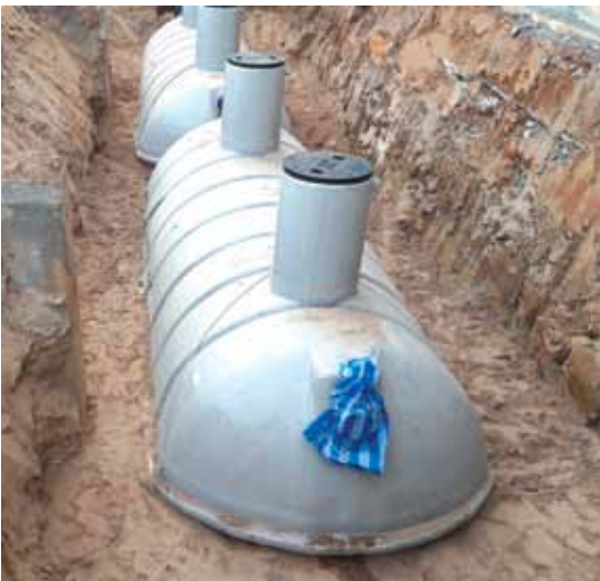
Foto 2.31 Tangki jenis besi
