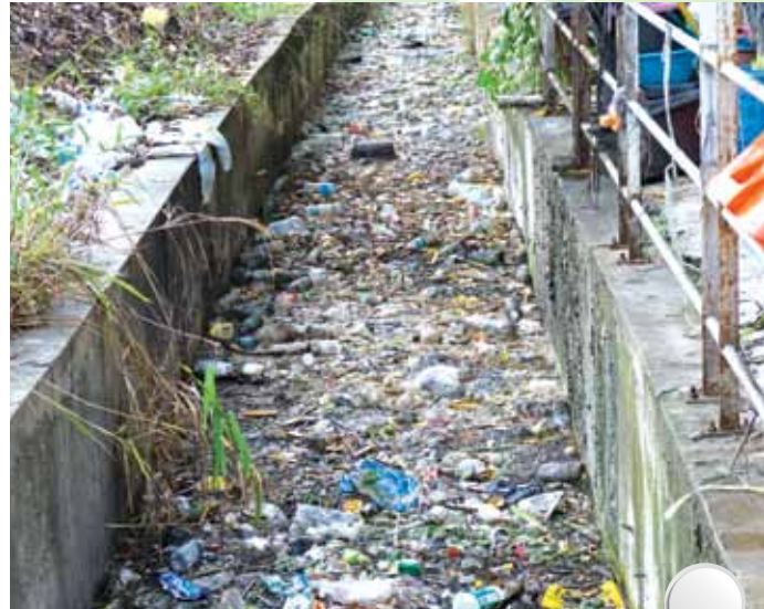
Foto 3.31 Sisa pepejal yang tidak diurus dengan baik
