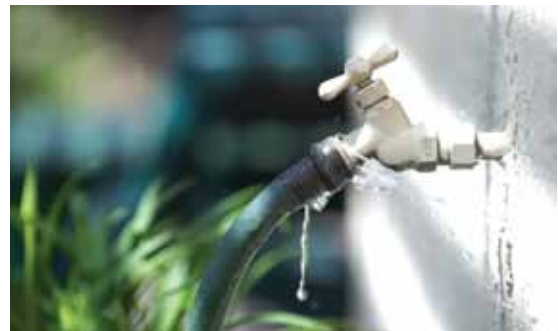
Foto 1.26 Penggunaan air yang tidak cekap
