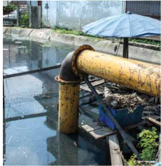
Foto 2.23 Air sisa kumbahan industri perkilangan
