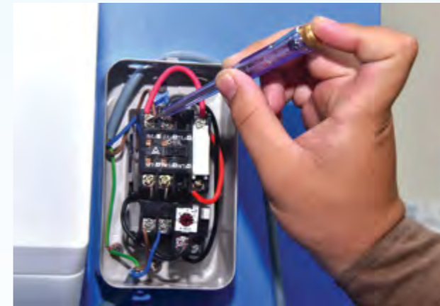
Memeriksa sumber bekalan arus elektrik dengan menggunakan pena ujian.
