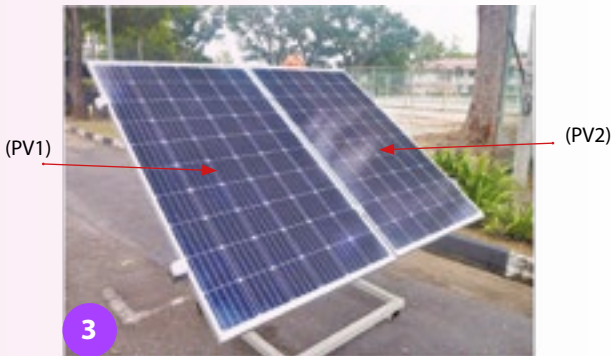
3 Kedudukan (modul) panel solar (PV) yang diletakkan di atas platform.
